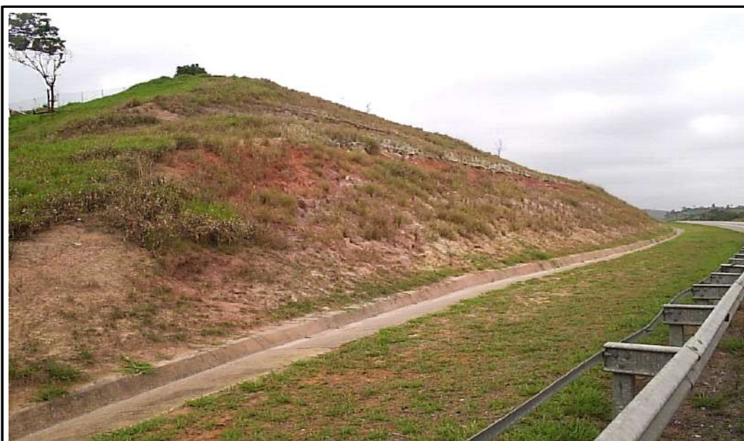
Foto 1 - SP070-CO-11 - Talude com erosão em toda sua extensão Falta vegetação e assoreamento na drenagem
