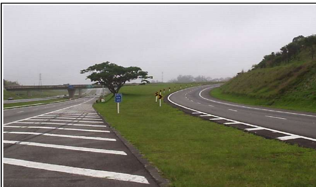
Foto 2-SP070-CO-05 - Escorregemnto em talude de corte
