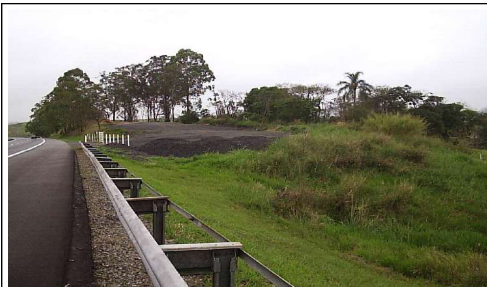
Foto 1- SP070-BF-01- Bota-fora em local inadequado, com risco de assorear área de APP
