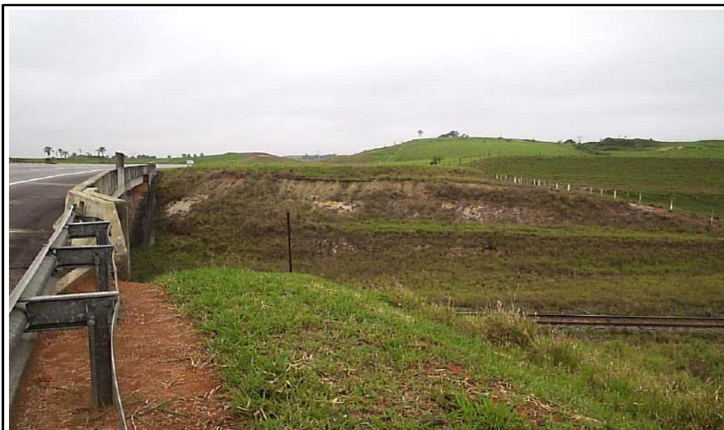
Foto 1- SP070-CO-01 - Erosão em talude de travessia de ferrovia Escorregamentos e cobertura vegetal com falhas
