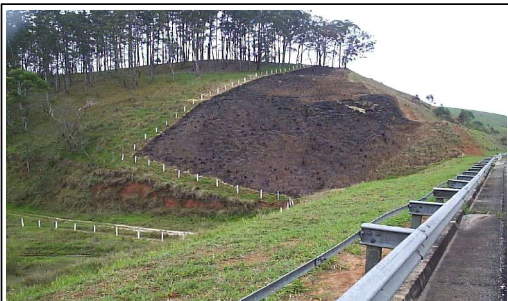
Foto 2 - SP070-CO-08 - Erosão com escorregamento do talude Talude de corte cuja evolução pode ocasionar assoreamento de corpo d'água.
