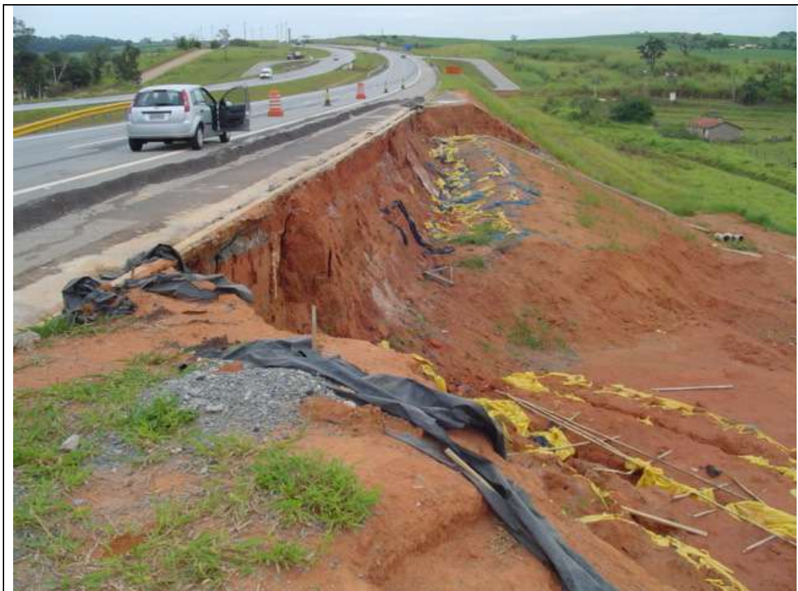
Foto 67 – Talude com erosão – km 116,5 (sentido São Paulo)
