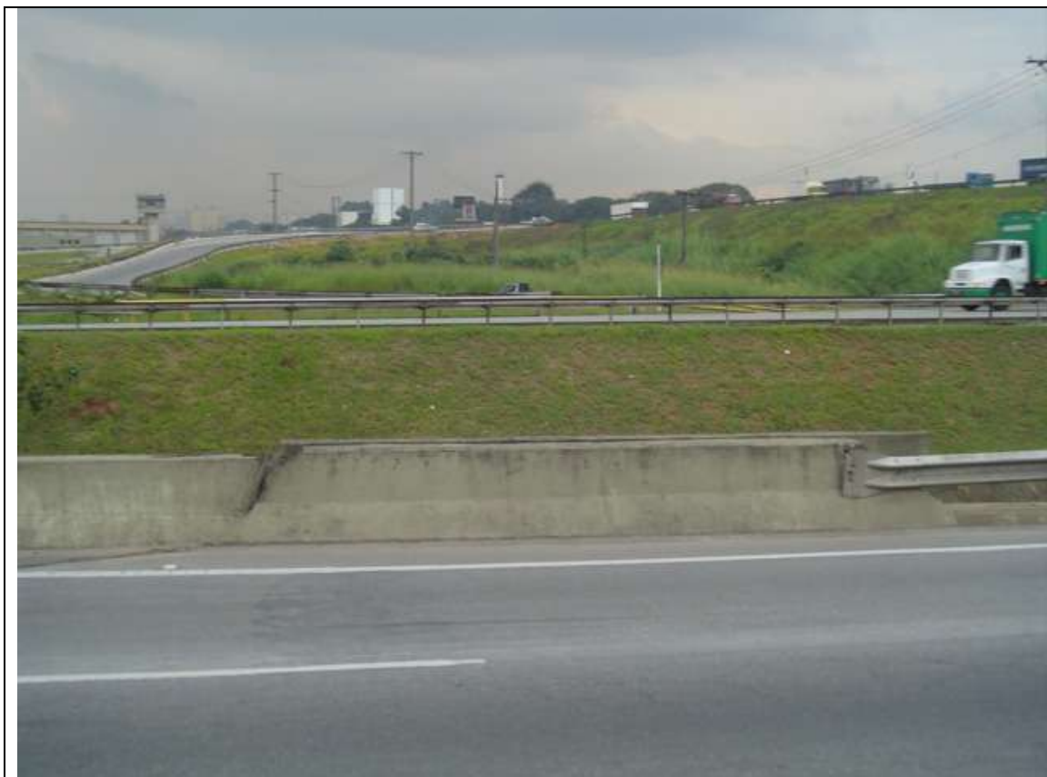
Foto 78 – Interseção Hélio Smidt – Dutra – km 2,0
