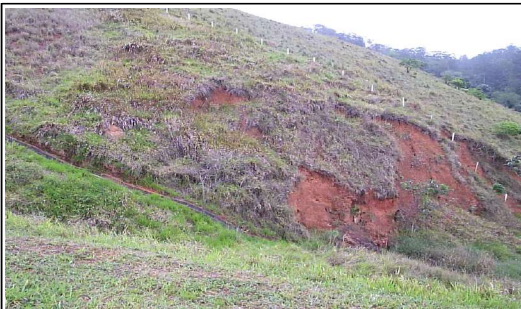
Foto 1 - SP070-CO-08 - Erosão com escorregamento do talude Talude de corte cuja evolução pode ocasionar assoreamento de corpo d'água.
