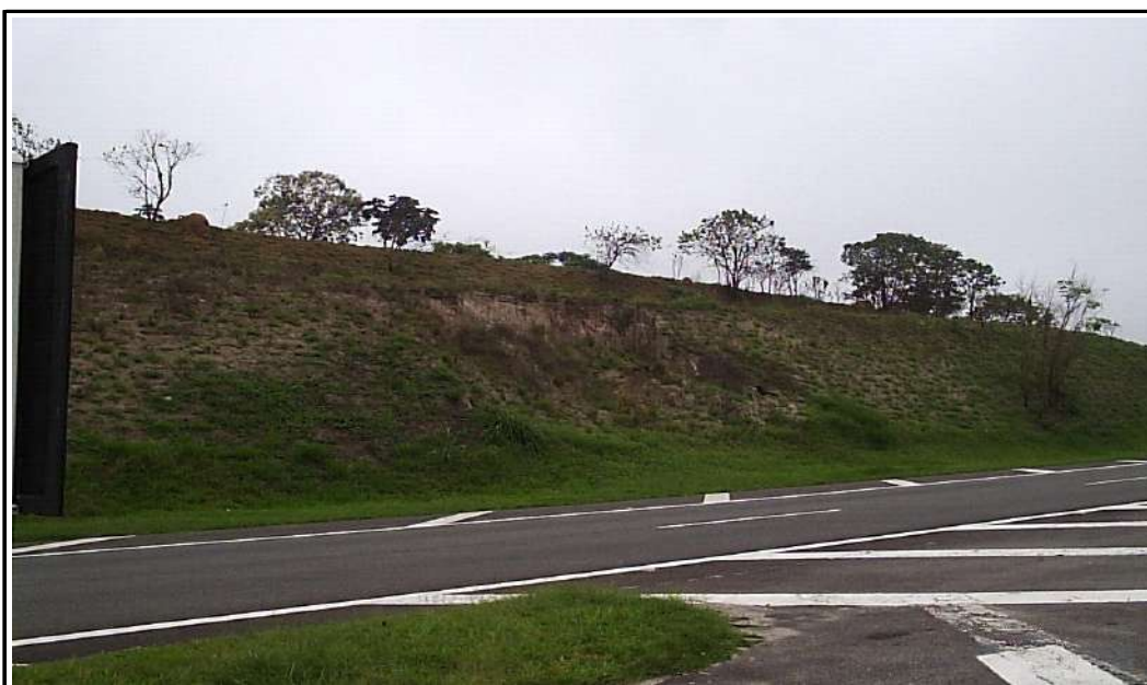
Foto 1-SP070-CO-05 - Escorregemnto em talude de corte
