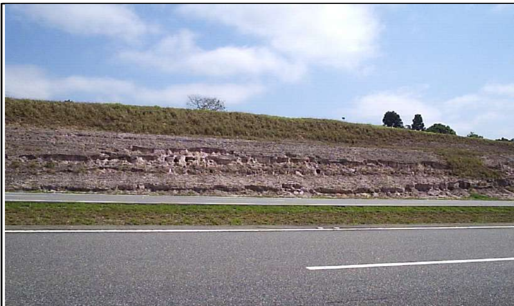
Foto 1 - SP070-CO-14- Talude com erosão em toda sua extensão Falta vegetação e assoreamento na drenagem
