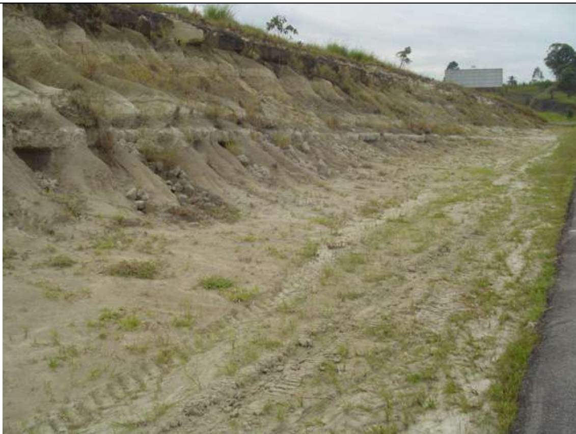
Foto 38 – Talude em erosão – km 54,8
