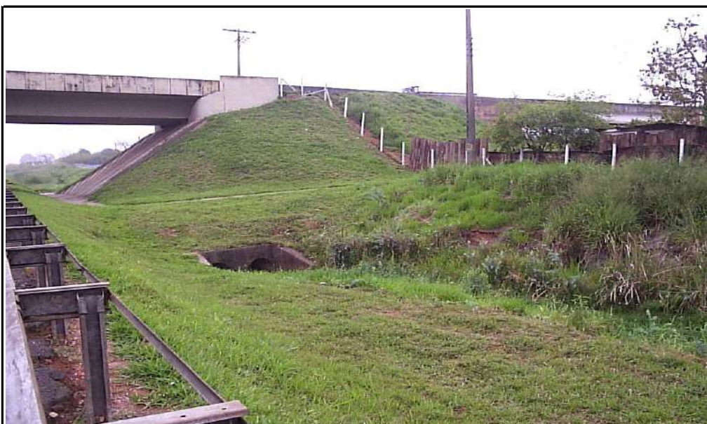
Foto-2 -SP070-CO-02 - Escorregimento nos taludes da drenagem
