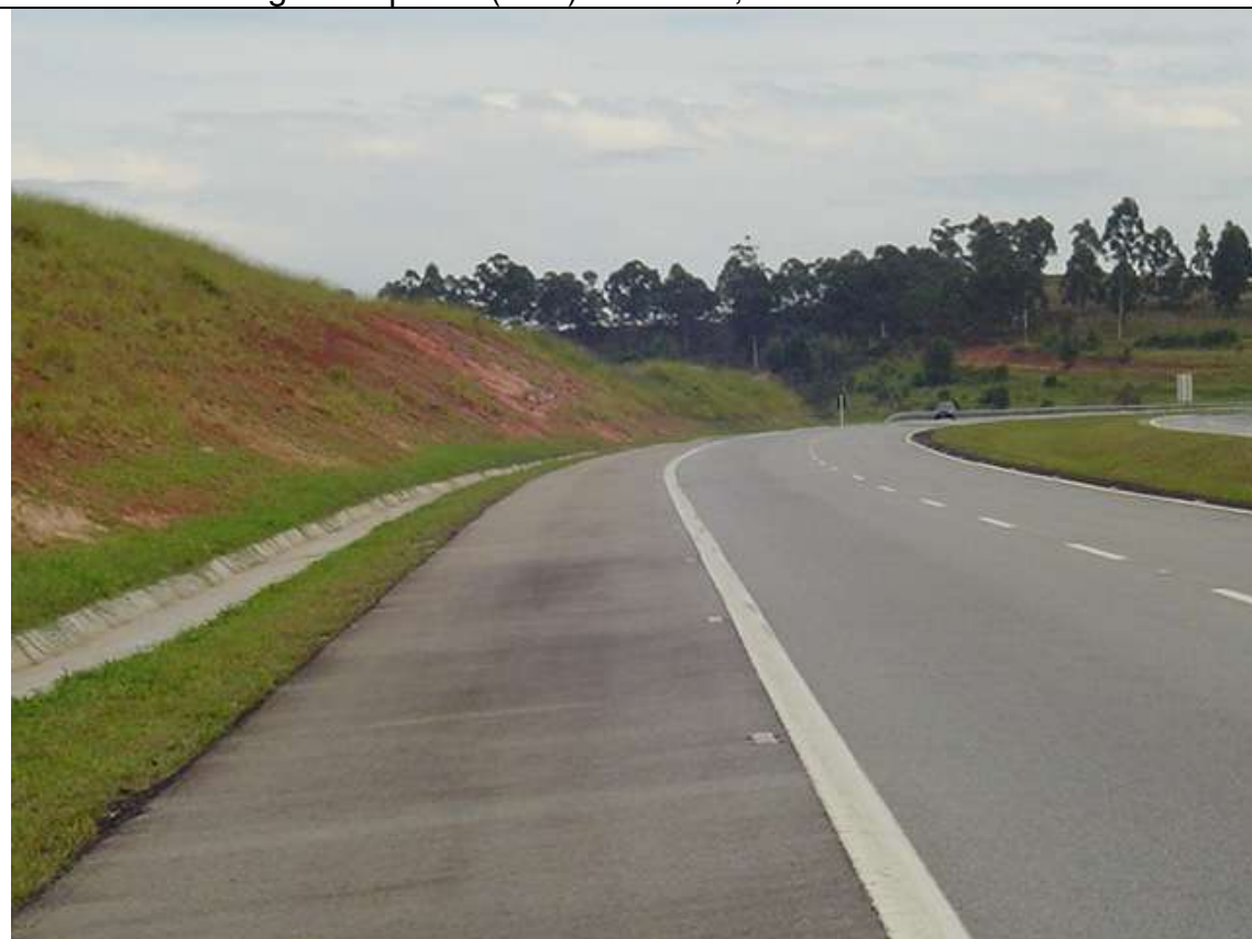
Foto 70 - Talude com erosão – km 120,3
