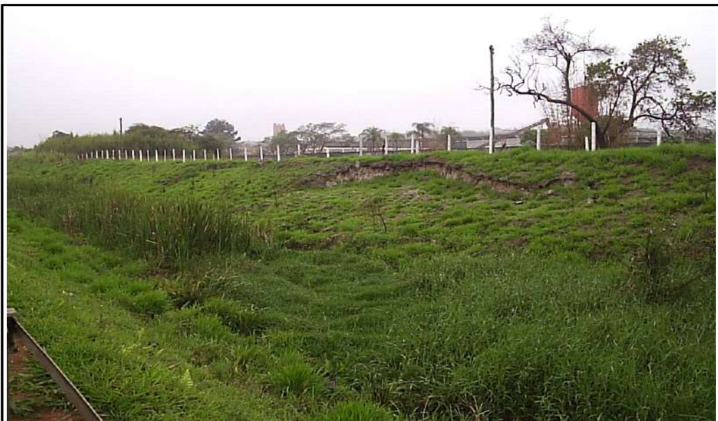
Foto 2 -SP070-CO-03 - escorregamento no talude da drenagem Assoreamento da drenagem
