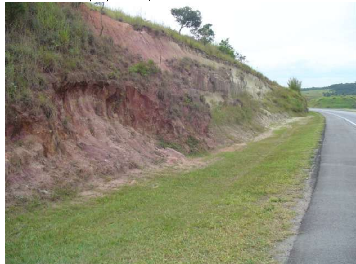
Foto 35 – Talude em erosão – km 52,5
