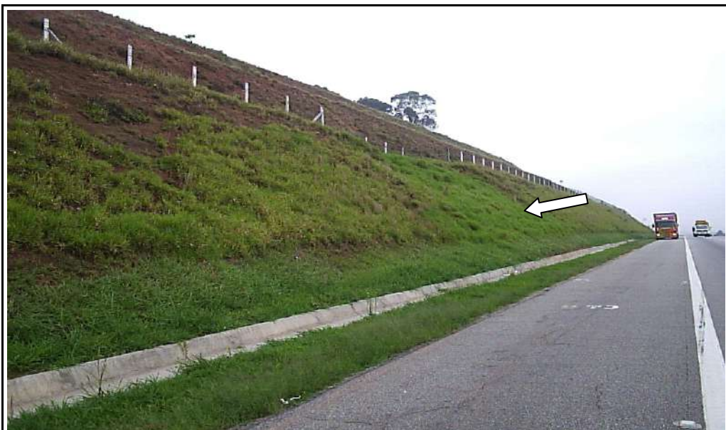
Foto 1- SP070-CO-01 - Escorregamento revegetado
