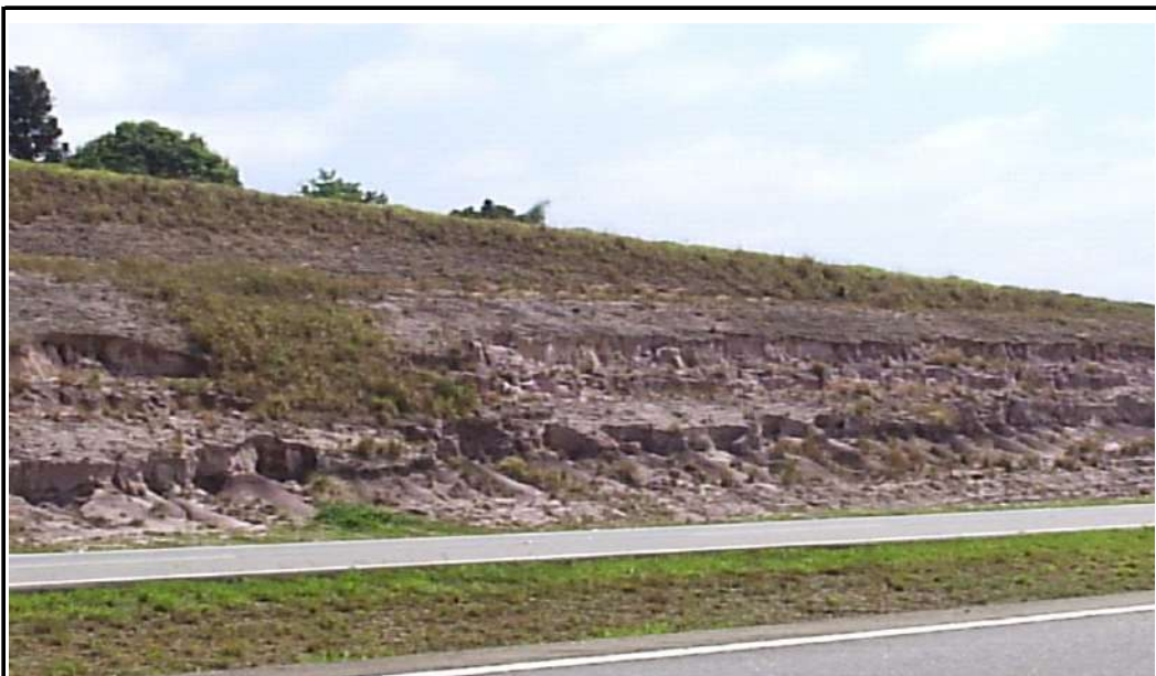
Foto 2 - SP070-CO-14- Talude com erosão em toda sua extensão Falta vegetação e assoreamento na drenagem
