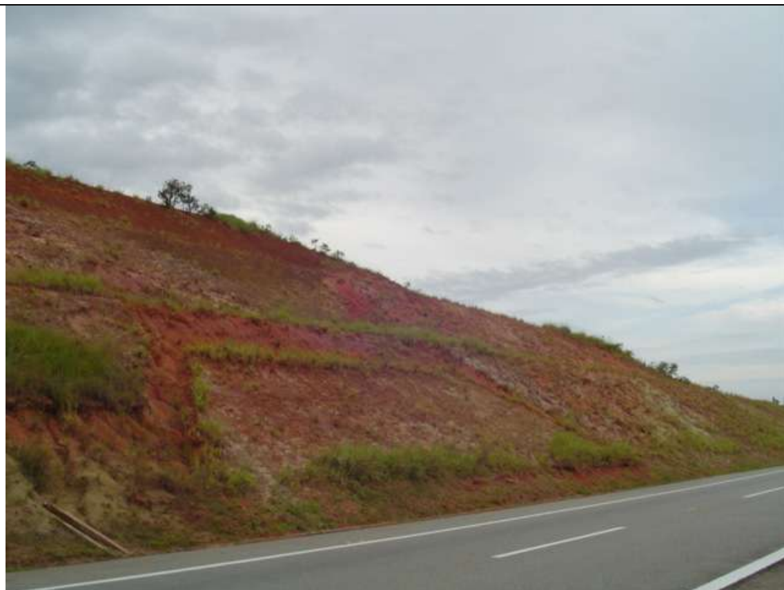
Foto 73 - Talude com erosão – km 122,0
