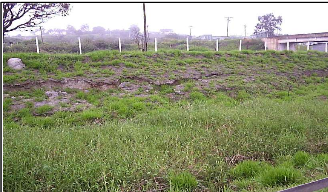
Foto 1 -SP070-CO-03 - escorregamento no talude da drenagem Assoreamento da drenagem
