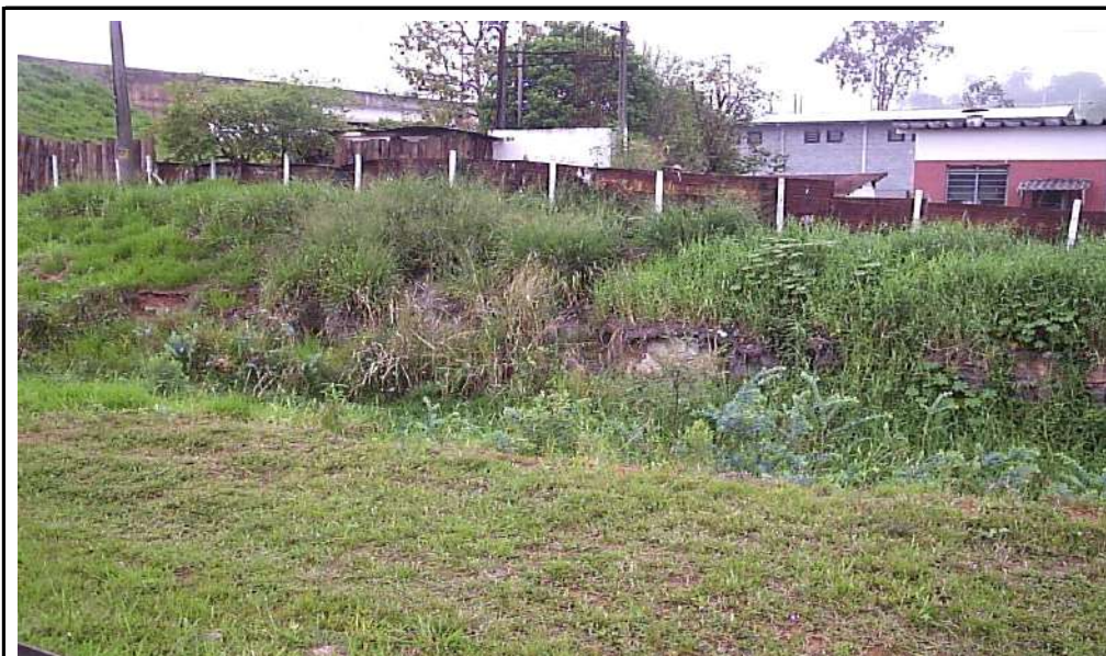
Foto-1 -SP070-CO-02 - Escorregimento nos taludes da drenagem
