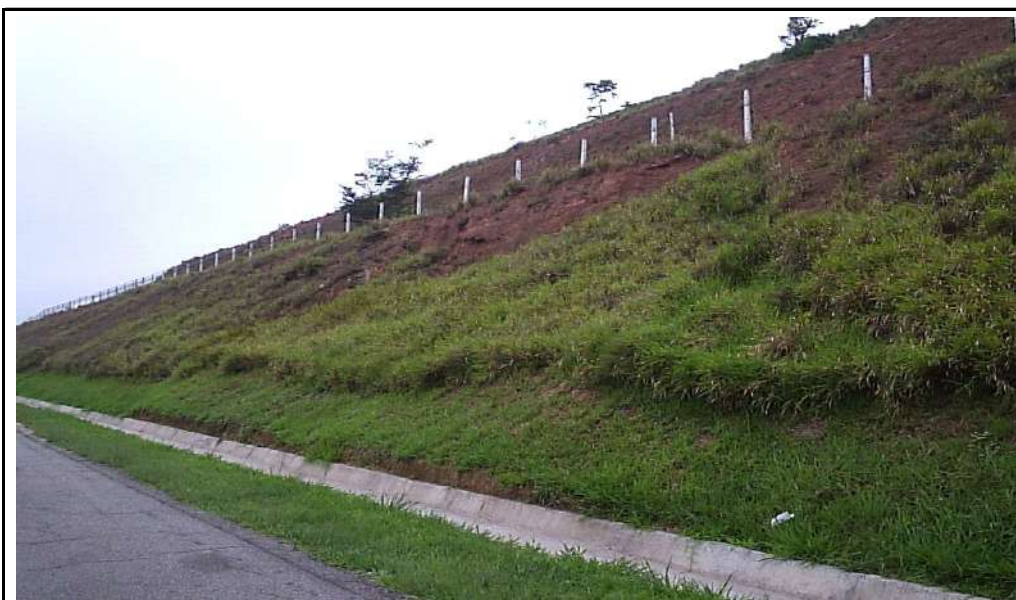
Foto 2- SP070-CO-01 - erosão em talude com deslocamento lento e contínuo de solo
