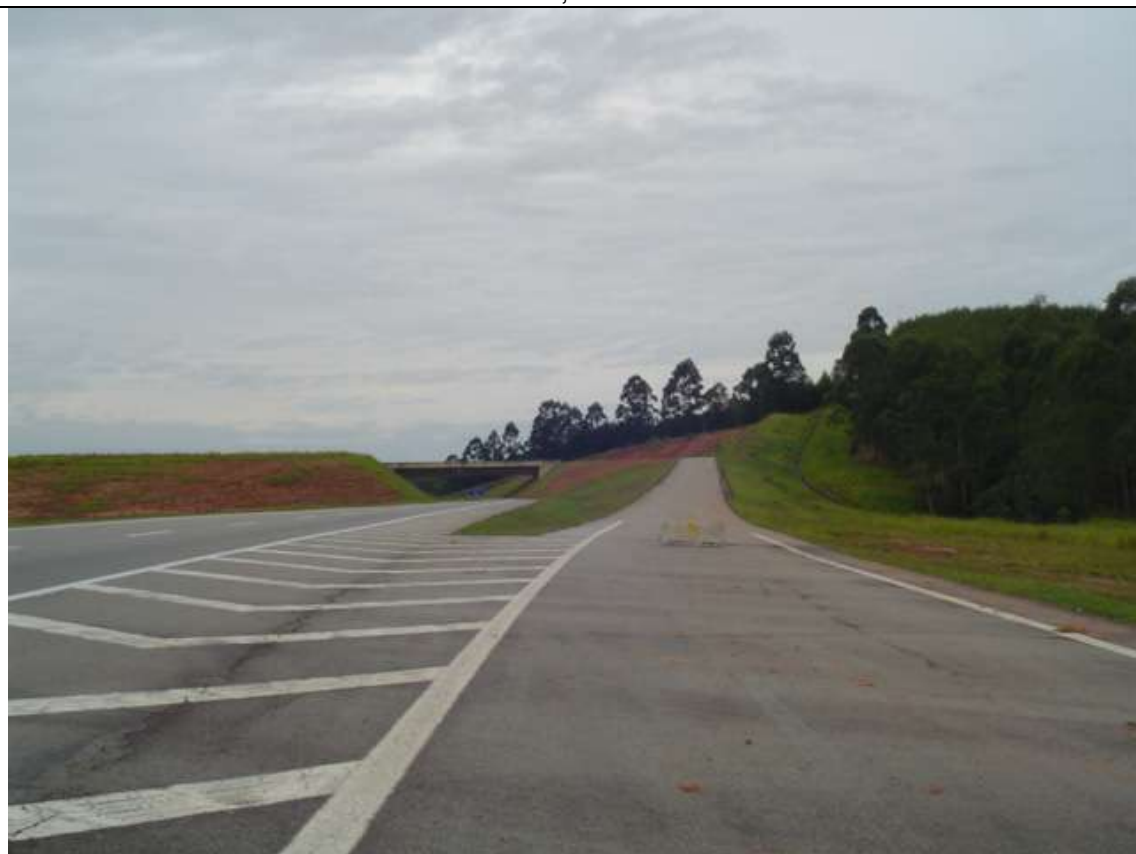
Foto 74 – Retorno (P.S.) 2 O.A.E. – tráfego impedido – km 124,0
