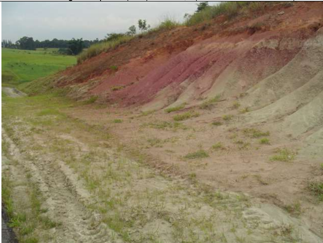
Foto 37 – Talude em erosão – km 54,8
