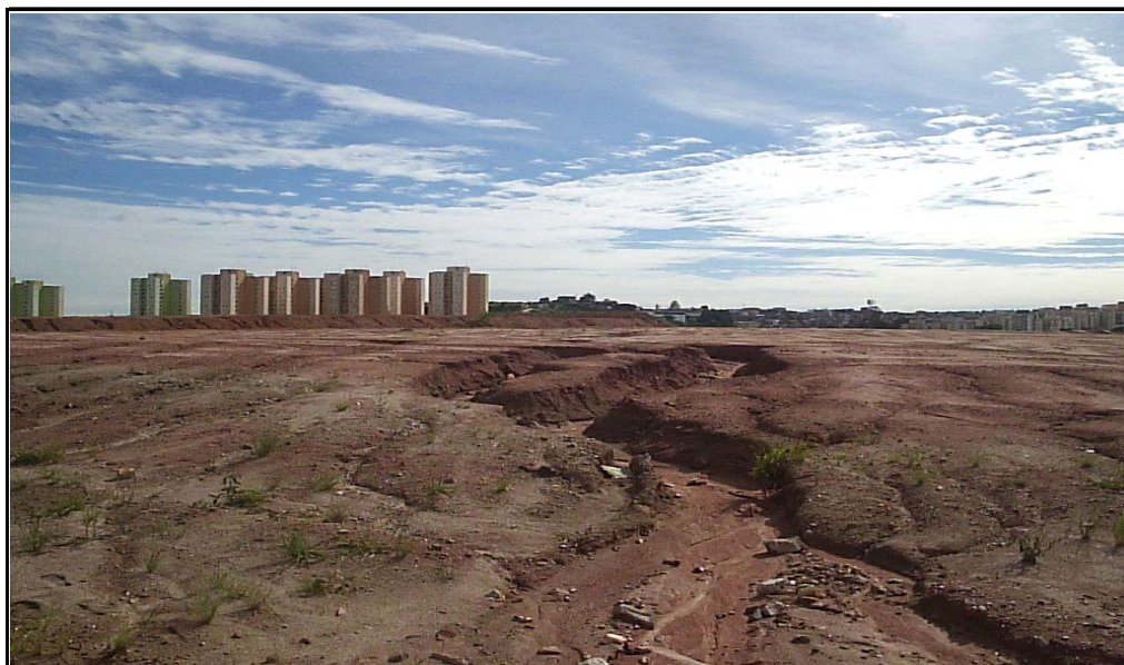
Foto 1 - AT-003 - Erosão com ravinamento devido ausência de canaletas de drenagem Assoreamento de córrego e de várzea - ausência de cobertura vegetal
