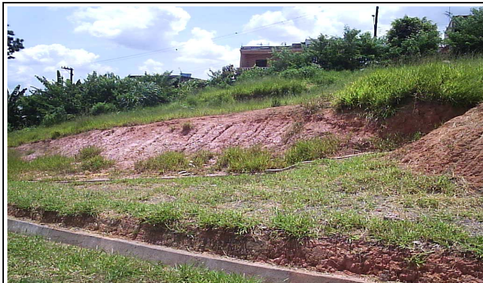
Foto 01- CO-001 - Erosão em sulcos em talude. Falta sistema eficiente de drenagem e cobertura vegetal
