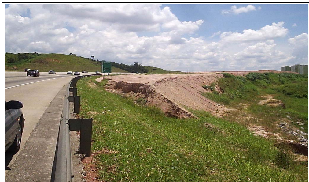
Foto 1 - AT-001 - Erosão de grande porte devido ausência de canaletas de drenagem Assoreamento de córrego e de várzea - ausência de cobertura vegetal
