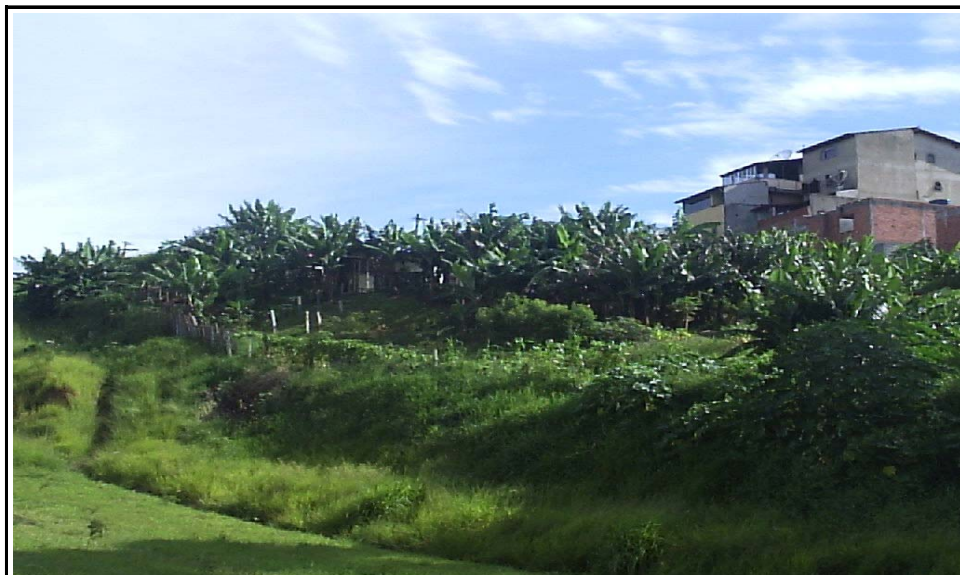
Foto 01 - NU-003 - Ocupação irregular da faixa de domínio Criação de animais no talude
