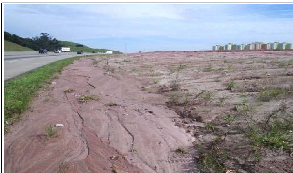
Foto 1 - AT-002 - Ravinamento devido ausência de canaletas de drenagem Assoreamento de córrego e de várzea - ausência de cobertura vegetal
