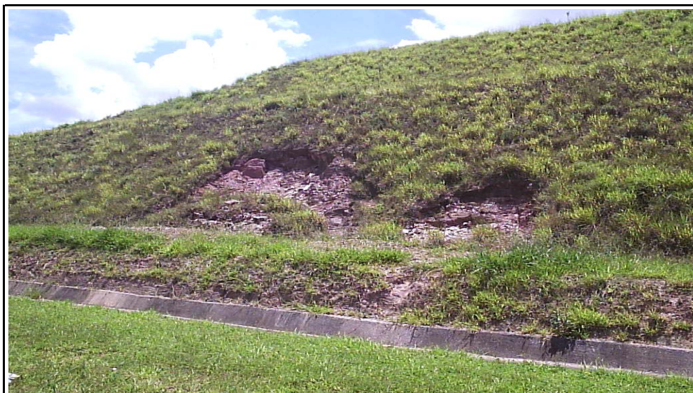
Foto 02- CO-003 - rastejo e erosão em talude. Falta sistema eficiente de drenagem e cobertura vegetal
