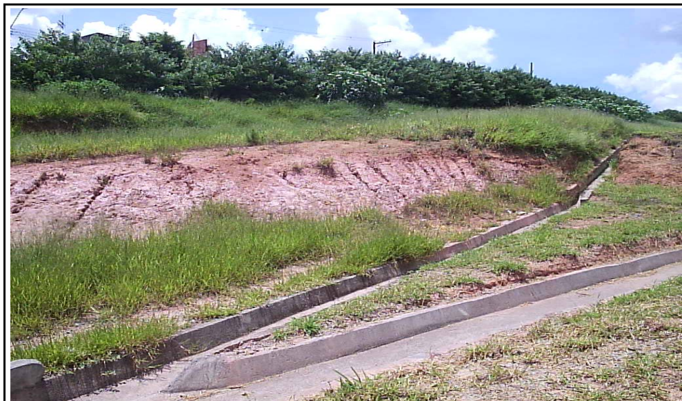
Foto 02- CO-001 - Erosão em sulcos em talude. Falta sistema eficiente de drenagem e cobertura vegetal
