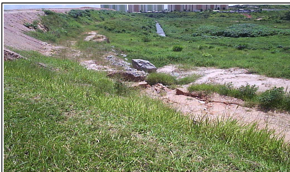
Foto 2 - AT-001 - Erosão de grande porte devido ausência de canaletas de drenagem Assoreamento de córrego e de várzea - ausência de cobertura vegetal
