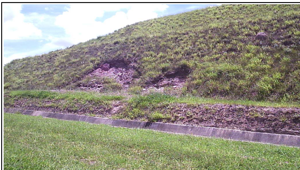
Foto 01- CO-003 - rastejo e erosão em talude. Falta sistema eficiente de drenagem e cobertura vegetal
