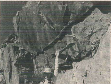
Foto 1.11. Executar medidas de estabilização de talude em rocha. Constatação de deslocamento dos blocos. Perigo de queda de blocos. (Km 32+900).
