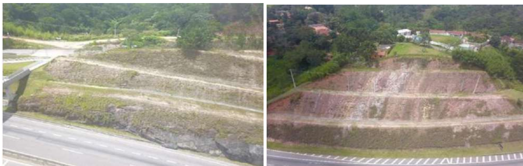
Figura 16: Talude 01 - Necessidade de recomposição vegetal.
