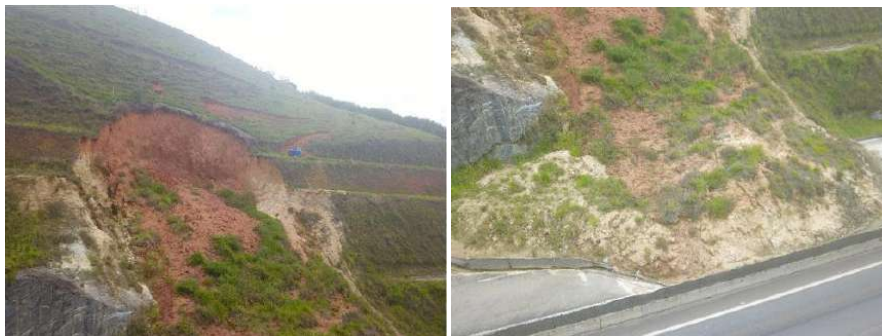
Figura 66: Talude 13- Trecho 2 rompido.
