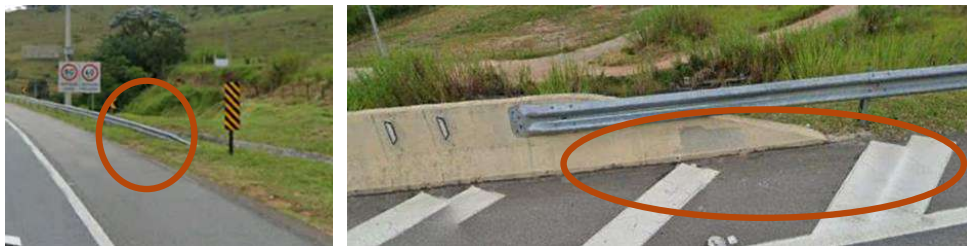
Figura 99: Falta de Atenuador de Impacto e Adequação de transição e implantação de tripla onda.
