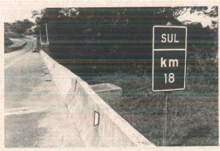
Vista sul da pista sentido litoral, com a caixa de contenção e o sistema de drenagem fechado.
