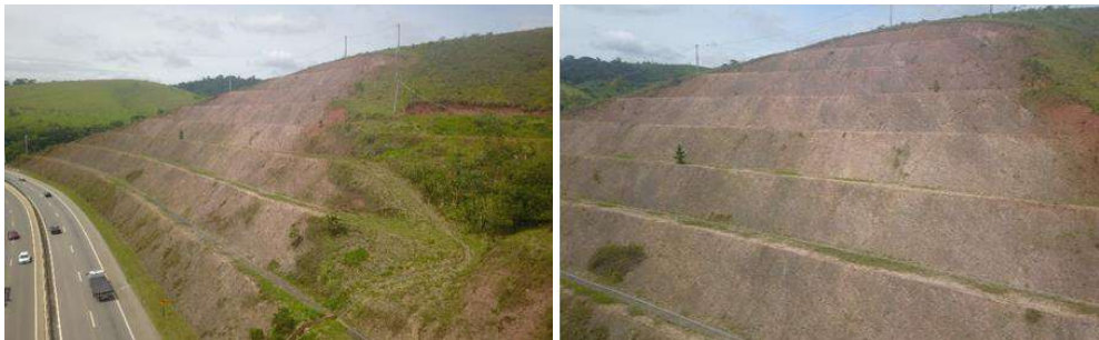
Figura 73: Talude 03 - Falta de vegetação.
