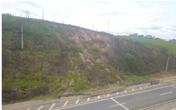
Figura 31: Talude 04 - Talude rompido por escorregamento.
