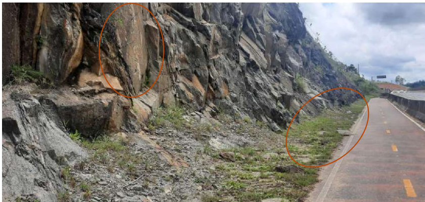
Figura 20: Talude 04 - Afloramento rochoso com fraturas e quedas de material.
