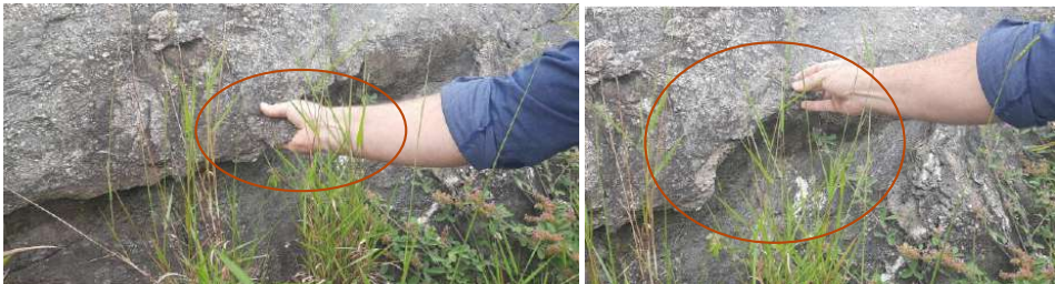
Figura 10: Talude 01 - Afloramento muito frágil.
