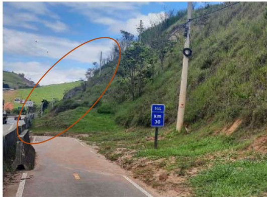
Figura 18: Talude 04: Obstrução da ciclovia devido a escorregamento.
