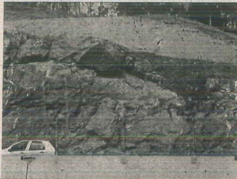
Foto 1.9. Executar medidas de estabilização no talude em rocha. Perigo de queda de blocos. (Km 26+700)
