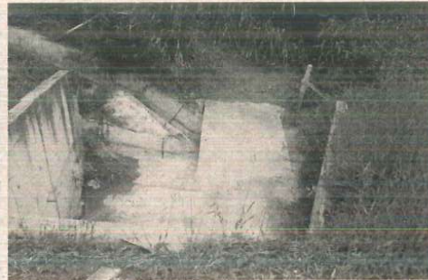
Detalhe da implantação de passarela de concreto no emboque da passagem de fauna no trecho do km 49+350.
