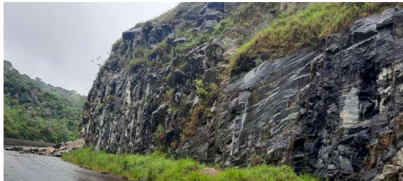
Figura 50: Talude 13- Visão Lateral do trecho rochoso.
