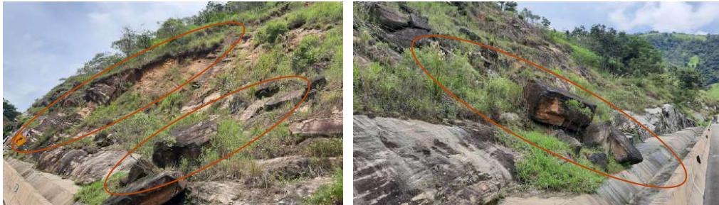
Figura 35: Talude 11 - Local de rompimento solo/rocha e blocos soltos.
