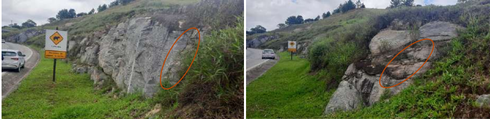
Figura 9: Talude 01 - Afloramento de Rocha fraturado.
