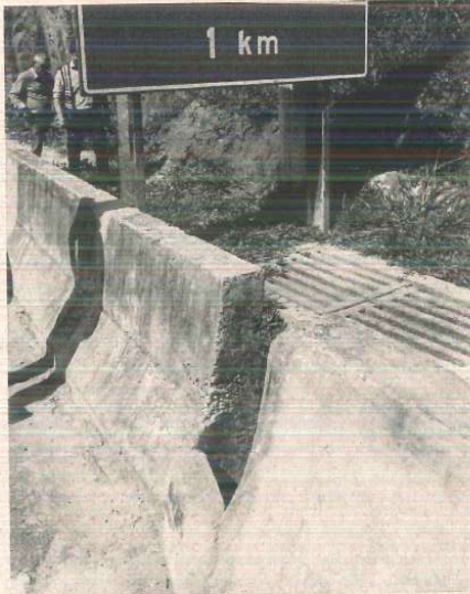
Trecho do guarda corpo localizado na extremidade sul da OAE, cuja drenagem está fechada, impedindo o lançamento direto no curso d'água.
