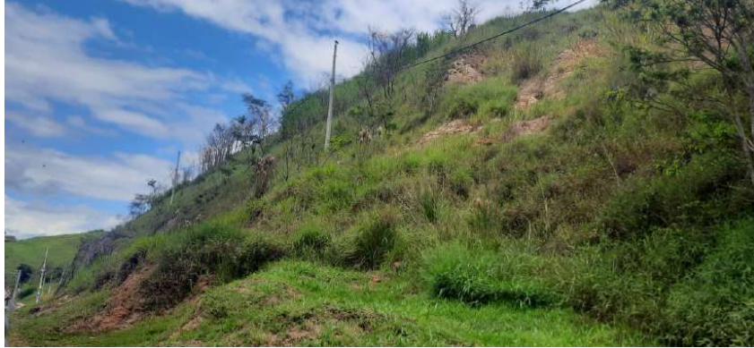
Figura 19: Talude 04 - Obstrução da ciclovia – visão frontal.
