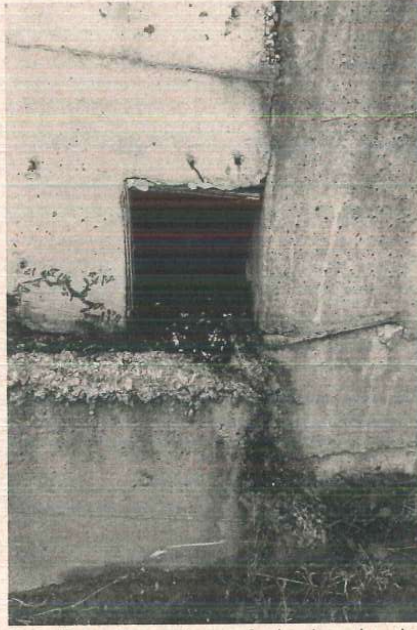
Detalhe da caixa, fechada do lado interno da pista.
