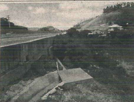
Foto 1.17. Readequar o sistema de drenagem pluvial, redirecionando o fluxo para a caixa de produtos perigosos. Lançamento parcial das águas no corpo d'água (Rio Paraíba) a poucos metros da captação pública do município de Paraíba (Km 35+300)
