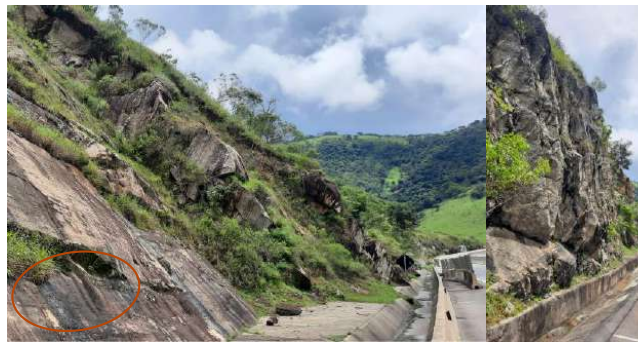
Figura 36: Talude 11 - Deslocamento de blocos e paredão fraturado.
