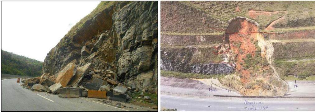
Figura 49: Talude 13- Rupturas na parede rochosa e do solo entre as estacas 17+00 e 19+10.
