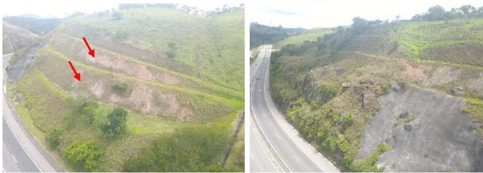
Figura 46: Talude 11 - Local necessário revegetação e parede em concreto projetado.
