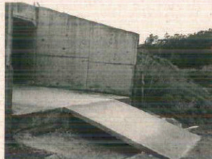
Foi implantada uma rampa de concreto no emboque da passagem de fauna com finalidade de eliminar o desnível existente no local.
