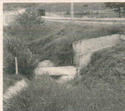
Passarela de concreto que foi implantada na saída do emboque da passagem de fauna.
