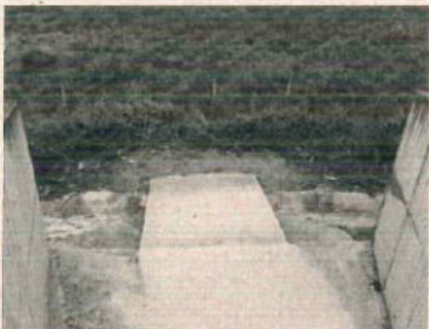
Vista de cima da rampa de concreto que foi implantada na saída do emboque da passagem de fauna do km 53+100.
