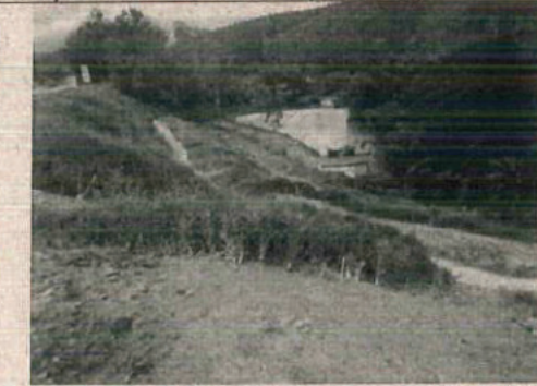
Fotos 1.5 e 1.6. Estabilizar os taludes e redimensionar o sistema de drenagem definitivo de modo a evitar o assoreamento da lagoa em propriedade lideira (Km 25).
