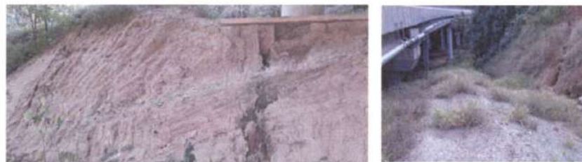
Talude de corte de encontro do viaduto, deixado em corte em solo a 90° e ângulos inadequados.
