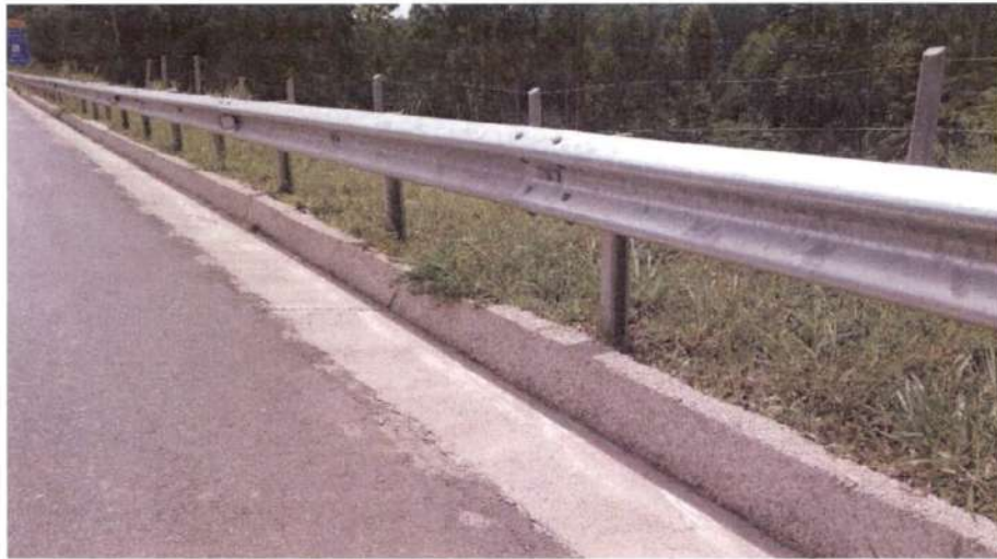
Postes de fixação instalados contrários ao fluxo dos veículos
